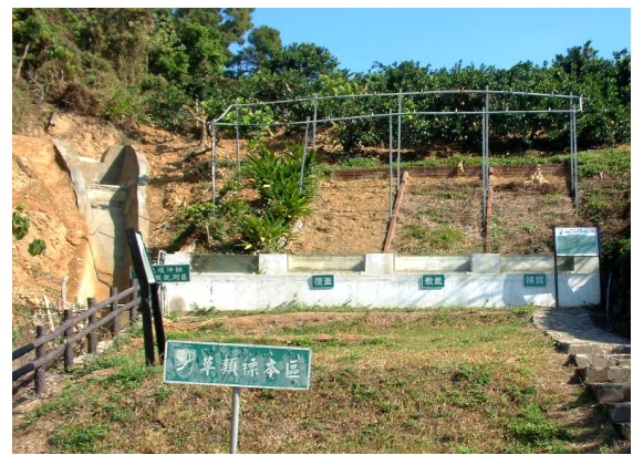
園區水土保持設施之一
